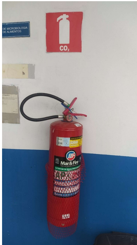
Figura 24 - Sinalização do agente extintor incorreta
