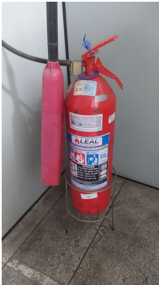
Figura 41 - Extintor com avarias na pintura e ferrugem
