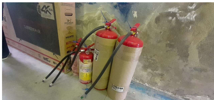
Figura 4 - Extintores armazenados no almoxarifado de MG
