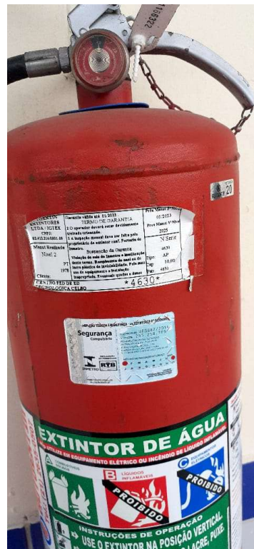
Figura 17 - Extintor com recarga vencida
