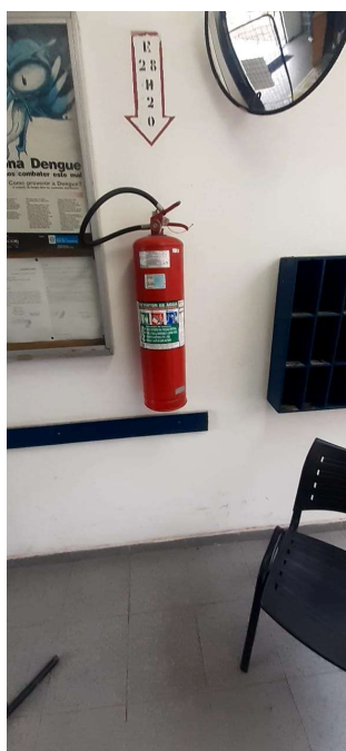
Figura 14 - Extintor em bom estado
