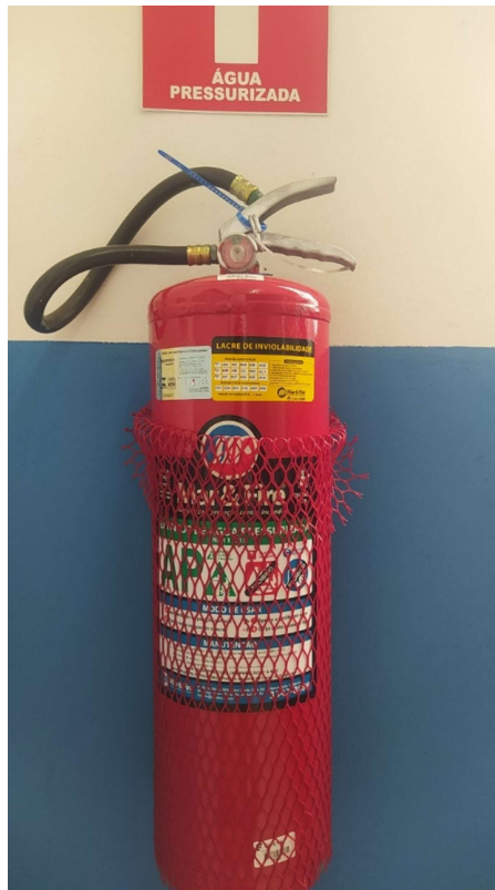
Figura 20 - Extintor corretamente instalado
