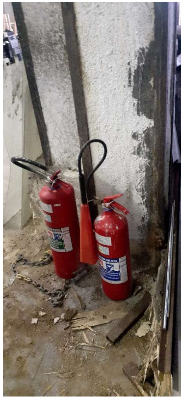
Figura 2- Extintores no chão
