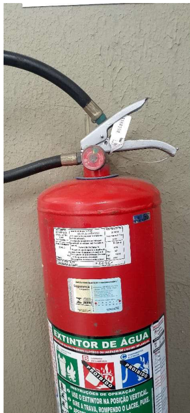
Figura 9 - Extintor sem lacre
