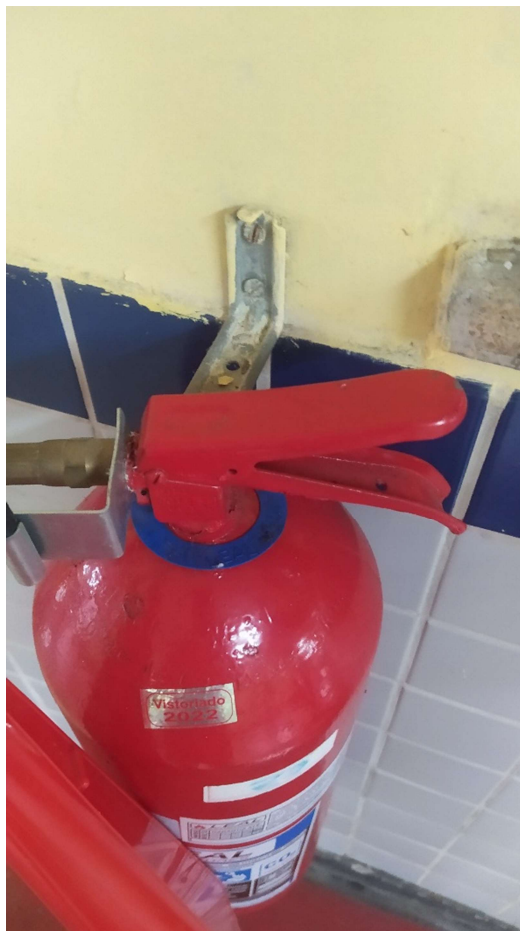
Figura 37 - Extintor sem lacre
