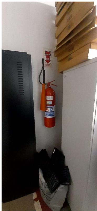
Figura 3 - Extintor com acesso obstruído
