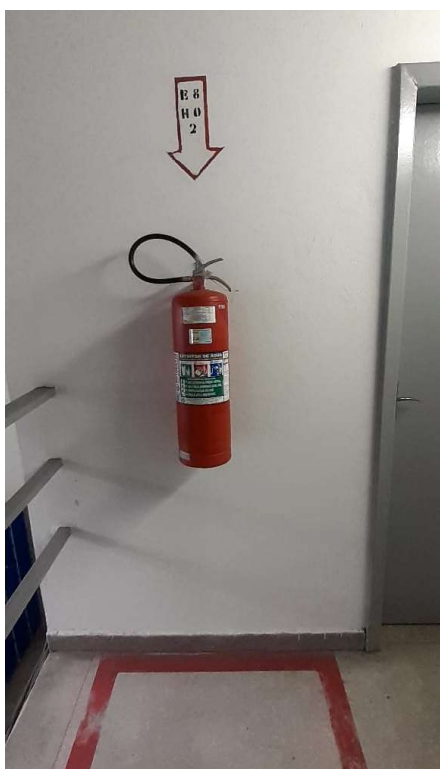
Figura 6 - Sinalização do tipo de agente extintor pintado na parede
