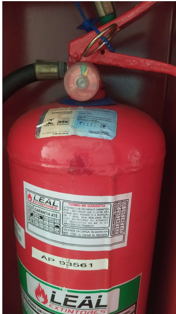
Figura 44 - Extintor com manômetro fora da posição de pressão correta, com recarga vencida e sem marcação de data de validade de reteste
