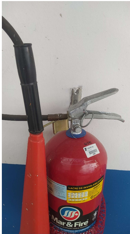
Figura 26 - Extintor sem lacre
