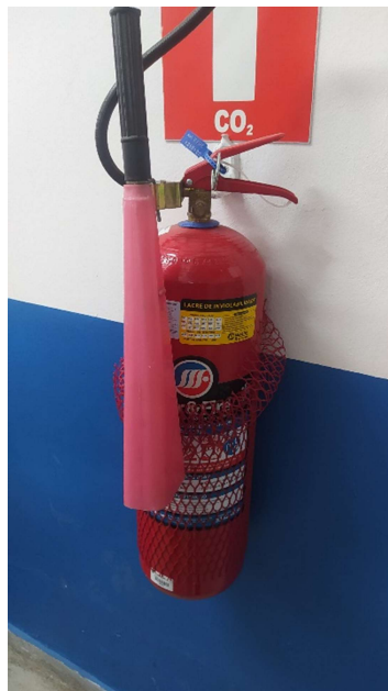
Figura 28 - Extintor em perfeitas condições em termos de instalação, sinalização e conservação de pintura e carcaça
