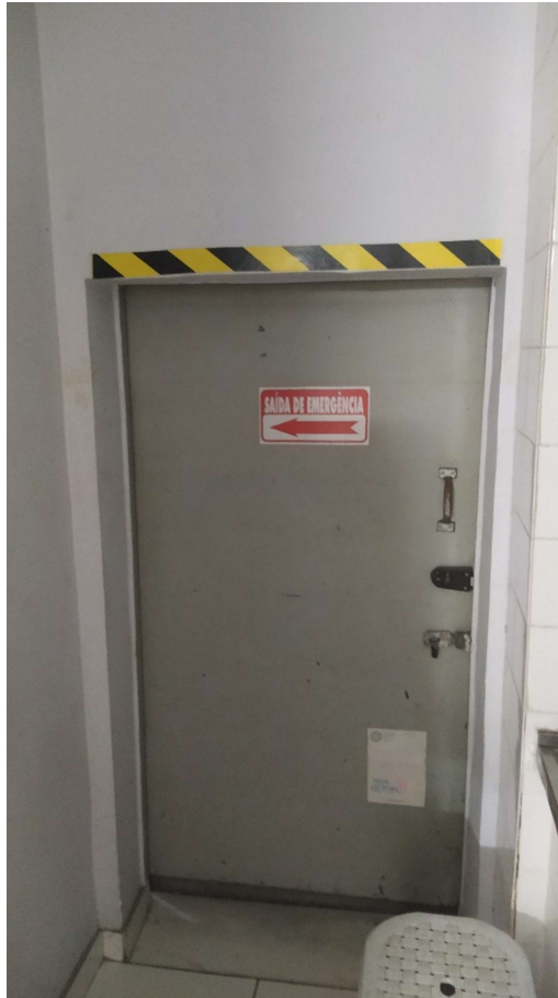
Figura 35 - porta da saída de emergência trancada, obstruída e de difícil acesso
