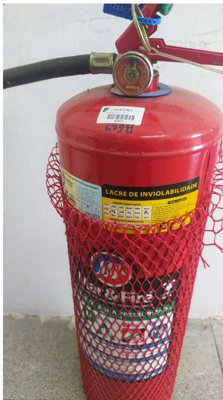
Figura 21 - Extintor no chão
