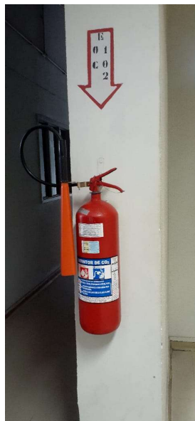
Figura 11 - Extintor com mangueira em bom estado
