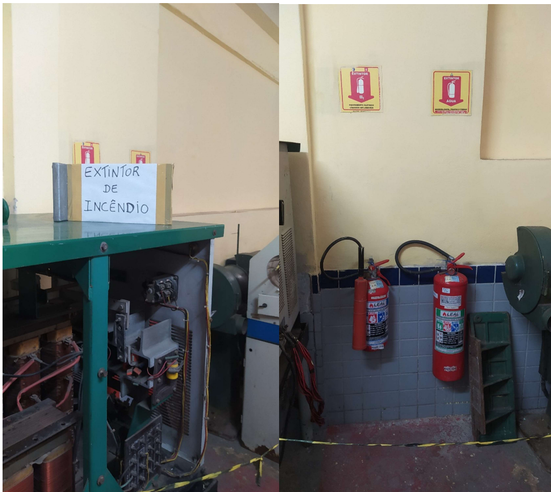
Figura 33 - extintores obstruídos e com sinalização inadequada
