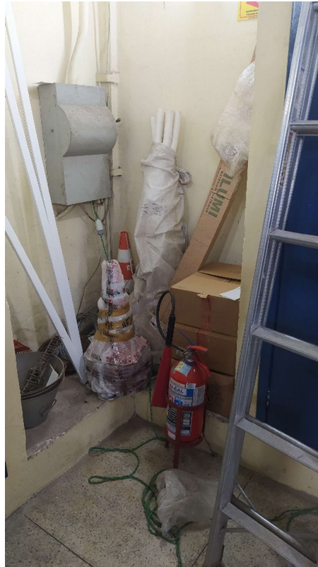
Figura 31- Extintor com instalação inadequada e acesso obstruído
