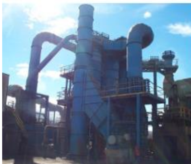
Figura 36: Sistema de despoeiramento
