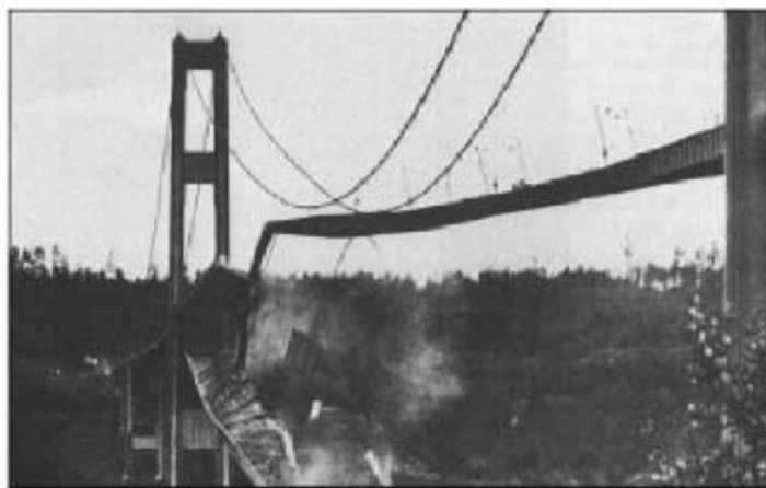
Figura 58 - Ponte de Tacoma após o colapso
