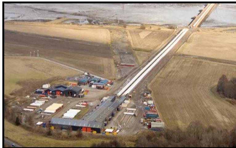
Figura 9: Base em terra ( Spool base )[6].
